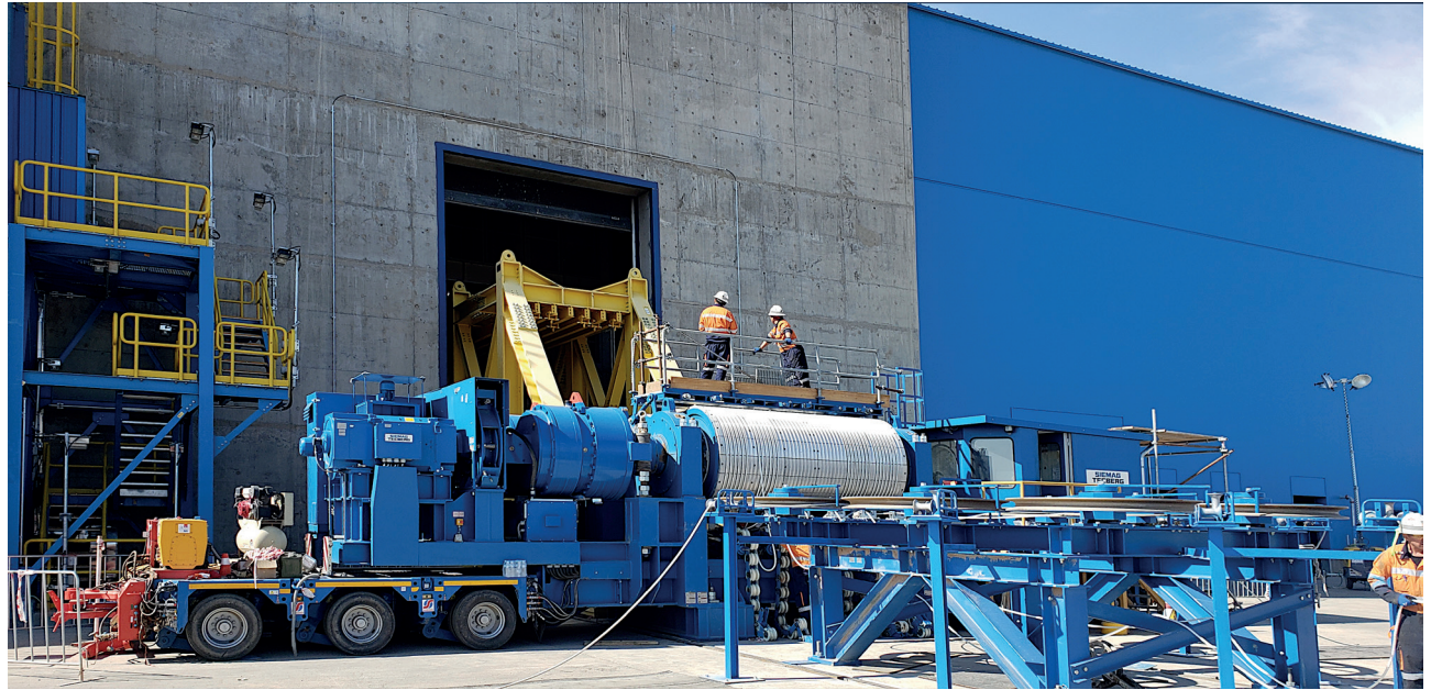
挂绳准备：机房前的移动换绳绞车，前方为水平方向的导向轮。
