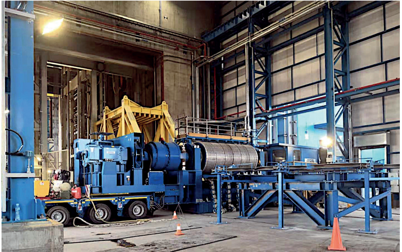
Vorbereitungen für das Seilaulagen in Schacht 2 mit mobiler Friktionswinde und horizontalen Umlenkscheiben.
