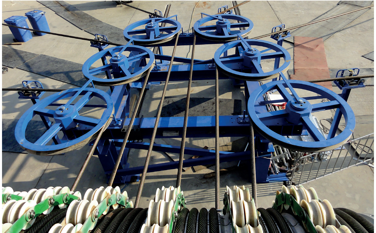
Aufnahme mit Blick von der Friktionswinde aus auf die horizontalen Ablenkscheiben mit einlaufenden Seilen.
