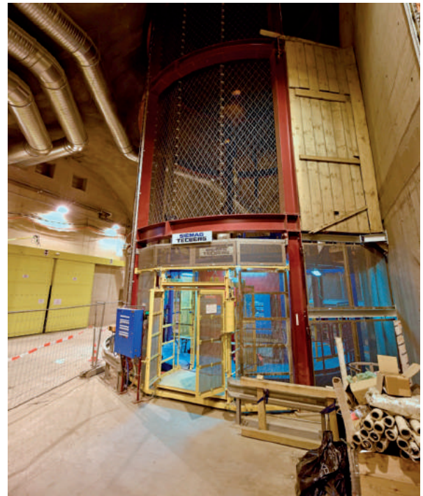
Bild 13: Schachtstuhl mit Zugangspodest MFS, Seilfahrtanschlagtafel und leicht demontierbaren Schachtabkleidungen
