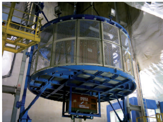
Bild 4: Inspektionsplattform als Mittlere Seilfahranlage (MSFA) in Parkposition
