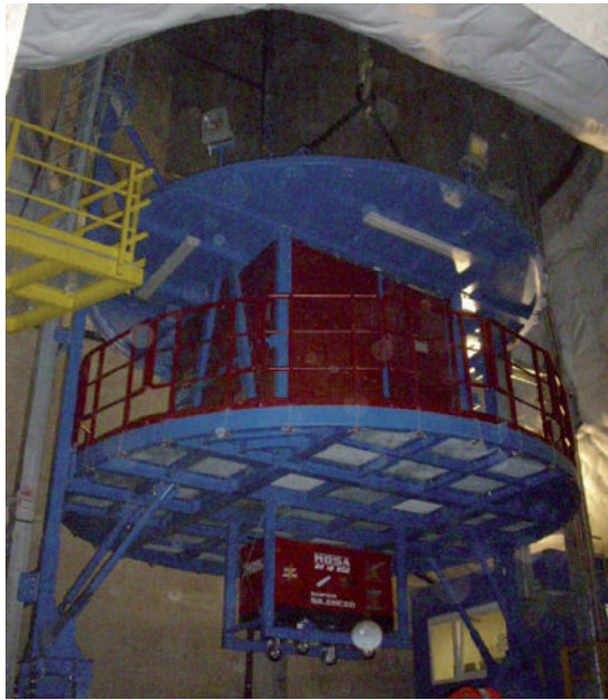
Bild 3: Inspektionsplattform (IPF) als Befahrungsanlage in Parkposition
