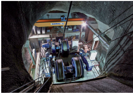
Bild 7: Blick aus dem Seilkanal auf die Schachtförderanlagen für die Betriebsphase GBT
