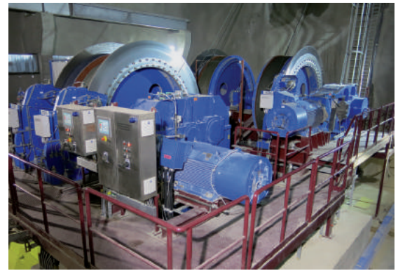
Bild 8: Blick auf die Schachtförderanlagen Los D; Vorne KT-Winde; Hinten IPF-Winde
