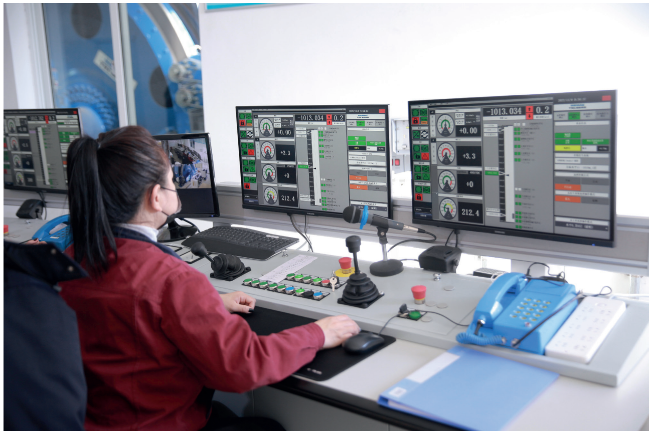
图3: 这三套提升系统的特点是集中控制系统。控制室位于副井的提升机大厅内。正常运行模式下, 生产井和副井的提升系统都处于自动提升运行状态。此外, 副井的两套系统都安装了井筒无线通讯装置, 可以直接从罐笼中控制提升设备。这使得人员能够直接到达不同的楼层。
