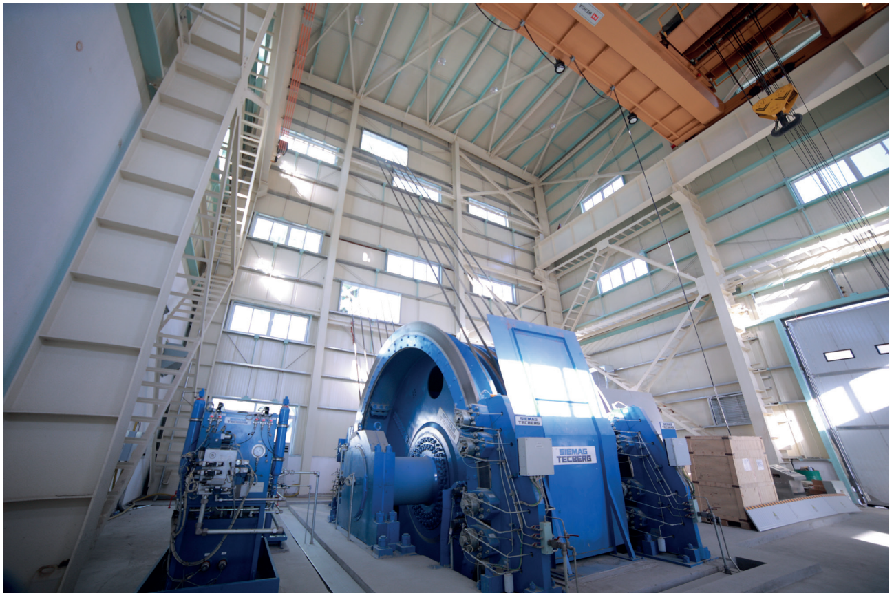
图1：副井的6绳摩擦式提升机正在运行中。
