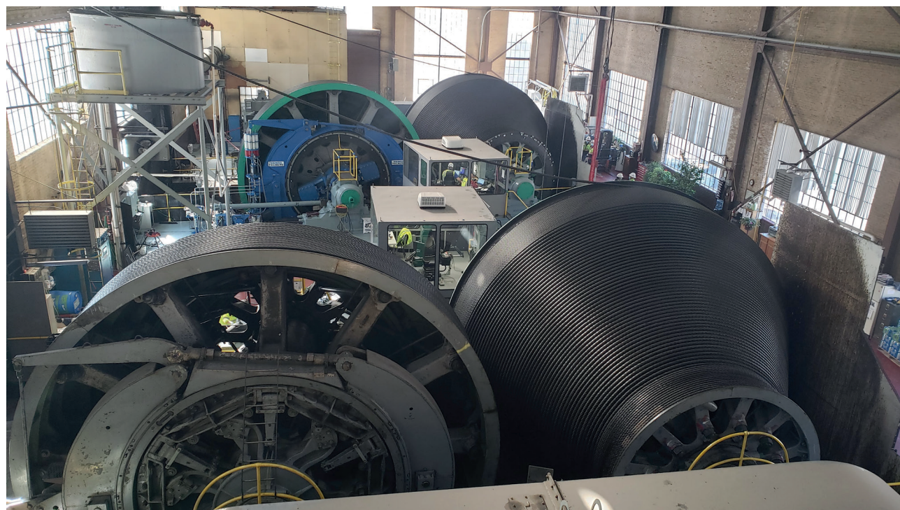
Rys. 4: Widok do maszynowni szybu Rossa z dwiema maszynami do nawijania bębnow - na pierwszym planie dwa bębny maszyny produkcyjnej; na drugim bębny maszyny do jazdy ludzi; pomiędzy nimi dwa stanowiska sterowania maszynami w ich kabinach operatorskich.
